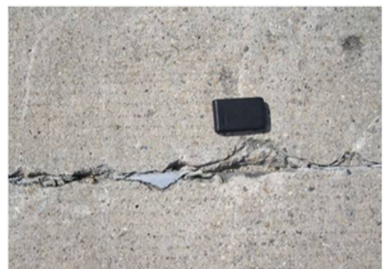
줄눈재 파손 - 심각도 : 상
