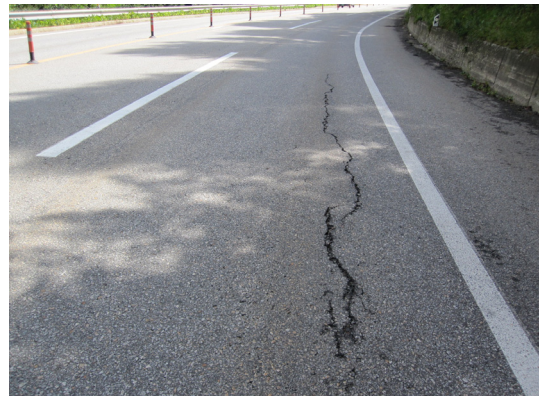
세로 방향 균열 - 심각도 : 중
