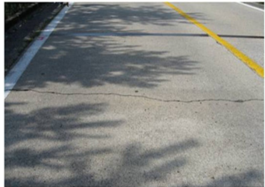
가로 균열 - 심각도 : 중
