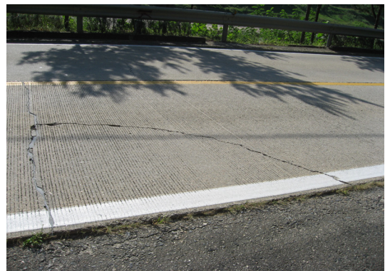
우각부 균열 - 심각도 : 상
