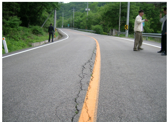
시공 균열 - 심각도 : 상
