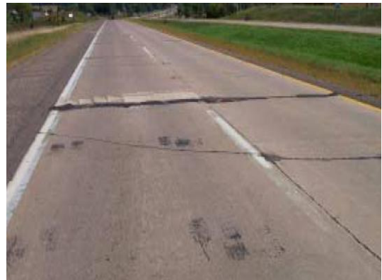
대각선 균열 - 심각도 : 중
