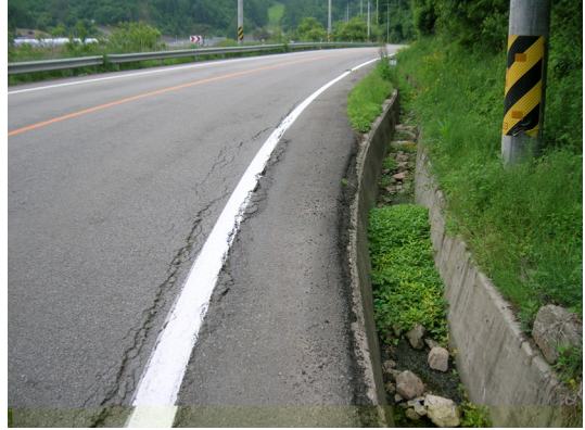
차로와 길어깨 줄눈 균열 - 심각도 : 중
