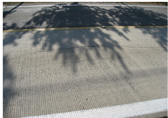
세로 균열 - 심각도 : 중
