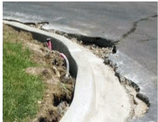
단부 균열 - 심각도 : 상
