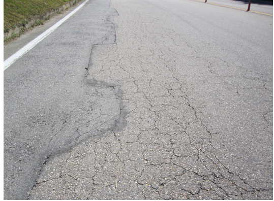
지하매설물 설치부 함몰 1
