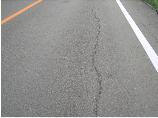
① 종방향 균열 모습
