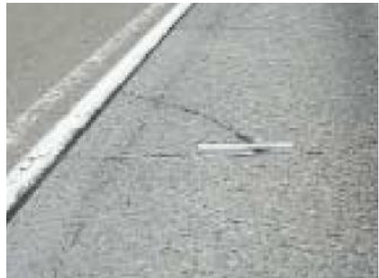
우각부 균열 - 심각도 : 중
