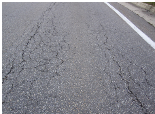
거북등 균열 - 심각도 : 상
