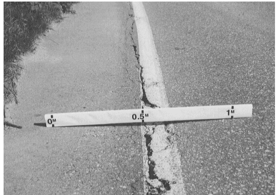
차로와 길어깨 줄눈 균열 - 심각도 : 상
