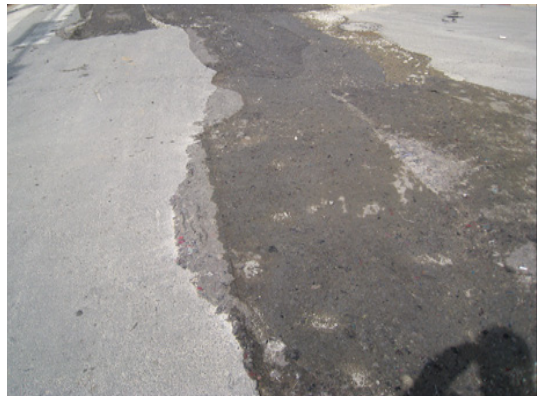
지하매설물 설치부 함몰 2
