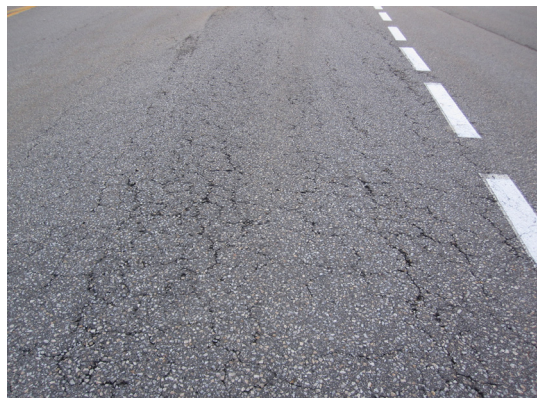
거북등 균열 - 심각도 : 중
