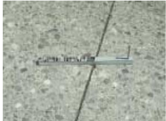
줄눈재 파손 - 심각도 : 하
