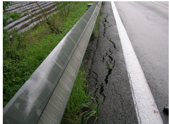
단부 균열 - 심각도 : 중
