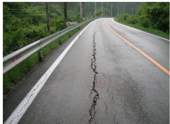
세로 방향 균열 - 심각도 : 상
