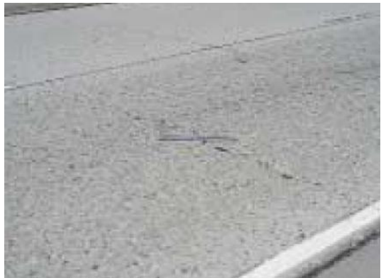
가로 균열 - 심각도 : 상
