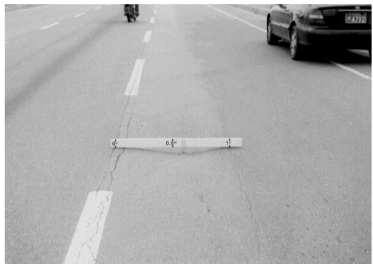
지하매설물 설치부 함몰 3
