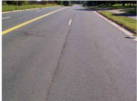
시공 균열 - 심각도 : 하
