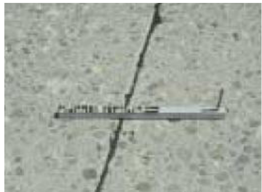
줄눈재 파손 - 심각도 : 중
