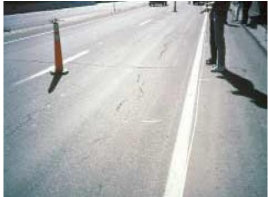
거북등 균열 - 심각도 : 하
